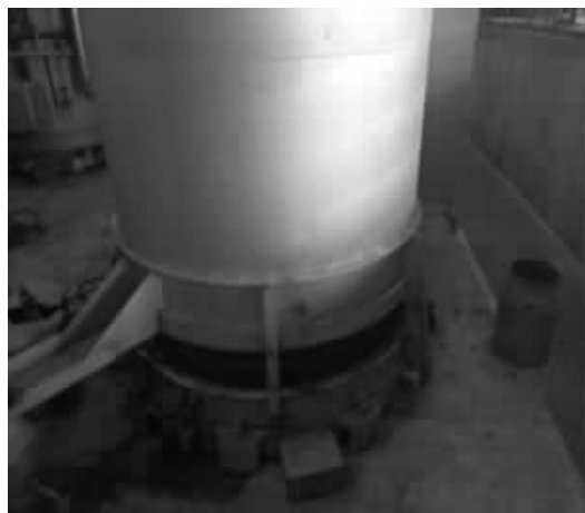
图5 EBNER 冷却罩底部
