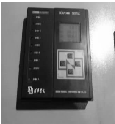
图 5 10kV 开闭所 1# 线装设在开关柜柜面的紫光光差保护装置 DCAP3111
