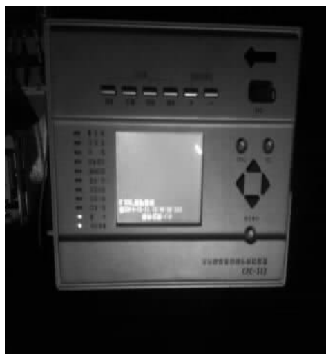
图 6 新增设安装在开关柜二次小室内的四方光差保护装置 CSC-213
