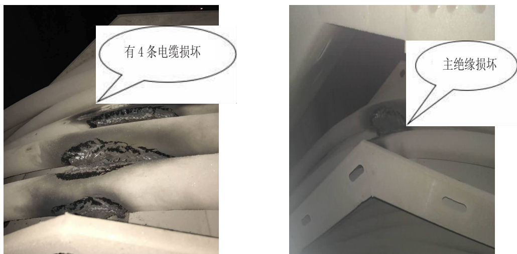
图1 电缆绝缘损坏情况
